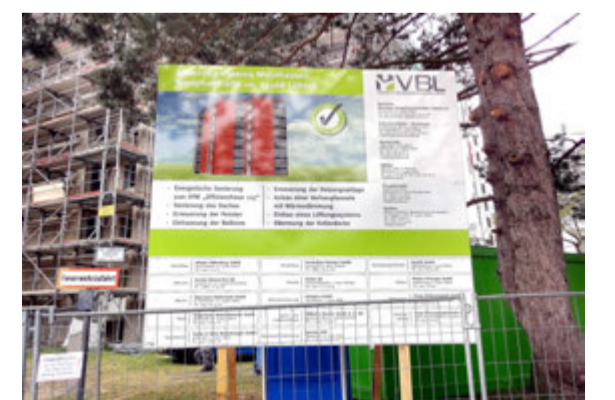
Vorzeigeprojekt: Die Energiekosten für dieses VBL-Haus werden bald deutlich niedriger ausfallen. vbl
